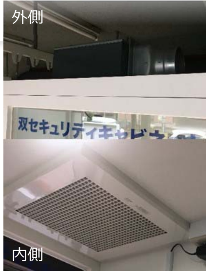
換気システム
