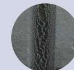
シーリングの凝集破壊
